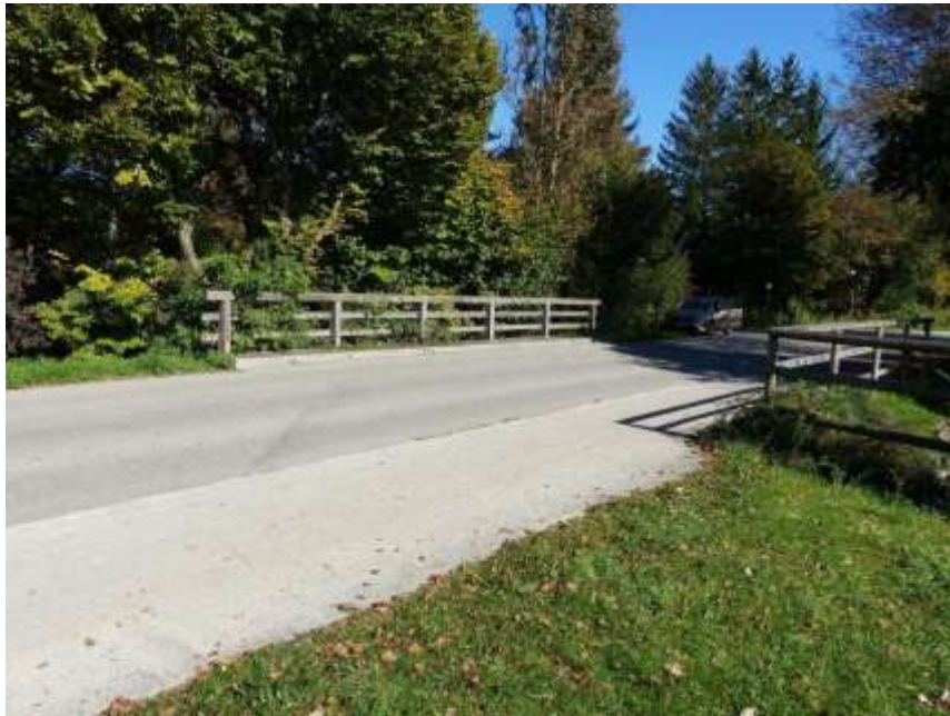
Brücke über den Mühlbach bei Furtmühle. Der Zustand des Brückenbauwerks wurde mit 4,0 bewertet, so dass Handlungsbedarf besteht Foto: Tobi Mayer
